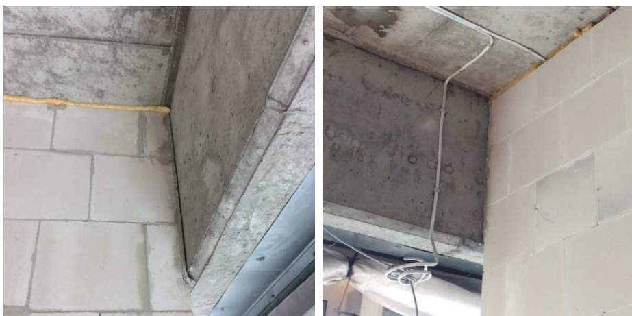
Rys. 7. Widok nieprawidłowego połączenia ściany murowanej z elementem konstrukcji nośnej budynku (brak warstwy elastycznej)
