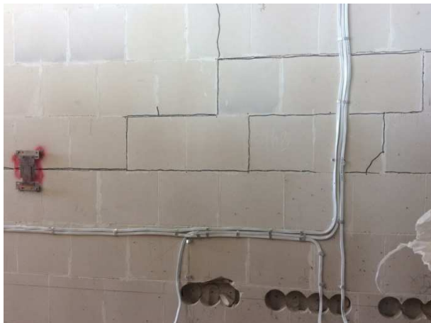
Rys. 8. Morfologia rys na murowanej ścianie działowej na kondygnacji +47 (widoczny zamontowany rysomierz)
